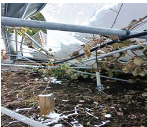
대설로 인한 과수시설 파손
