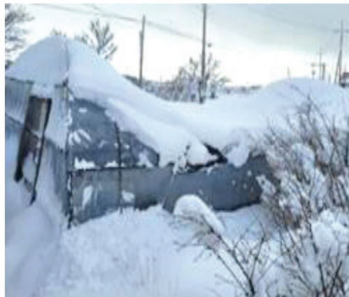
대설로 인한 사설하우스 파손
