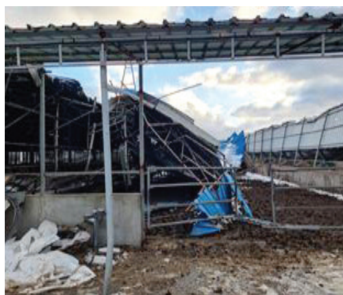
대설로 인한 축사 파손
