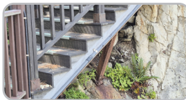
행사장 시설 파손
