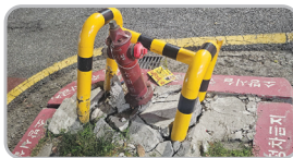
소화 시설 파손
