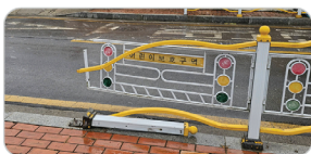
어린이보호구역 안전시설 파손
